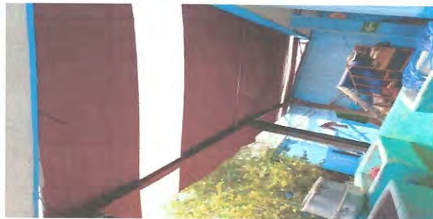
Foto 2: sustitucion de laminas debido a que se encuentra en mal estado en el área de la pila.
